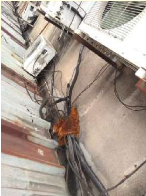
Fiação exposta com fixação improvisada sem isolamento antichamas
