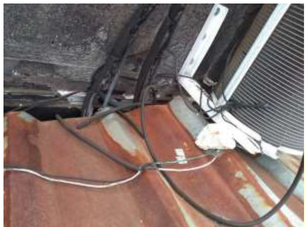
Fiação elétrica funcional exposta sob o telhado
