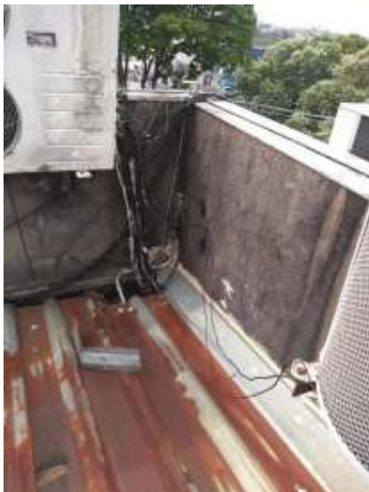
Fiação elétrica exposta e desgastada sob o telhado
