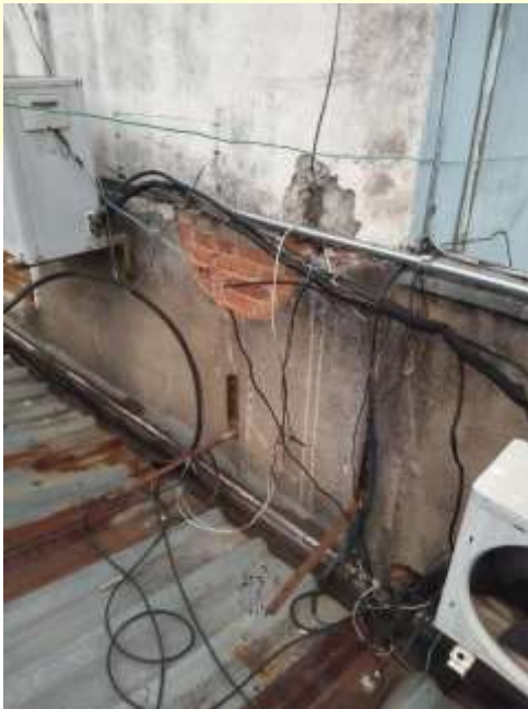
Fiação elétrica funcional exposta sob o telhado
