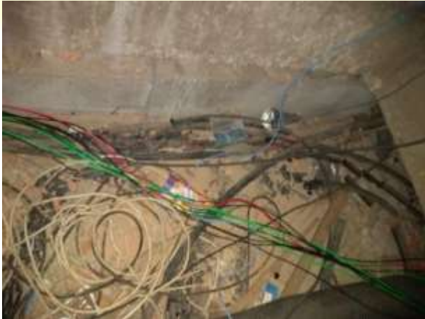
Fiação exposta sob laje, circuitos ao lado de tubulação hidráulica
