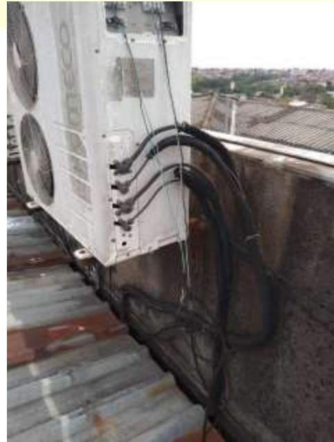
Fiação exposta em maquinário sem aterramento sem padronização de cores de circuito
