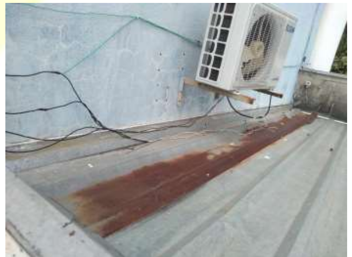
Fiação exposta sem isolamento, sem padronização de cores por circuito, com fixação improvisada
