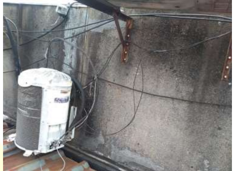
Fiação elétrica funcional exposta sob o telhado
