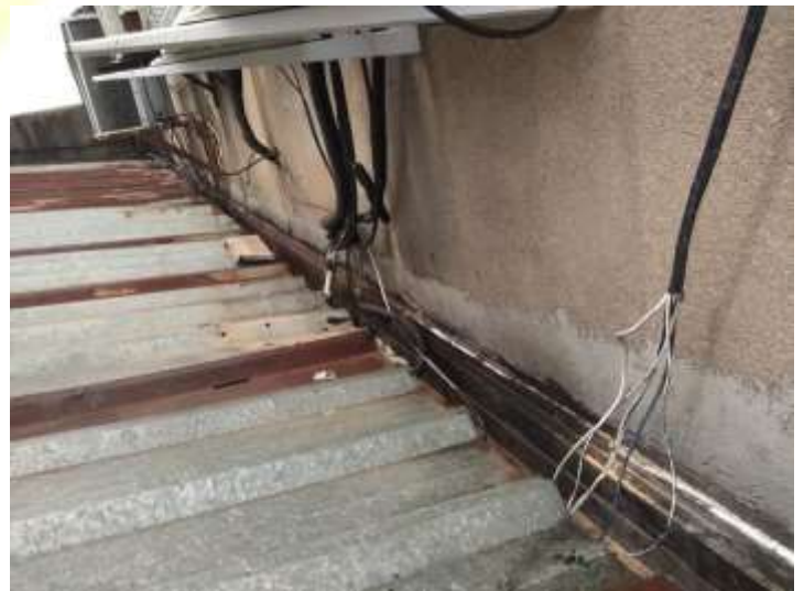
Fiação sem isolamento, sem padronização de cores e exposta sob o telhado.
