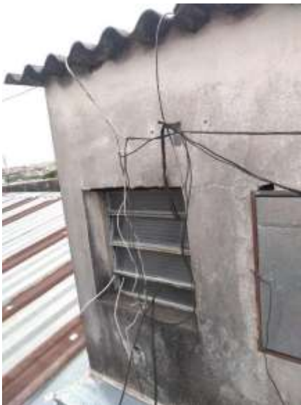
Fiação exposta na entrada da sala de máquinas sem isolamento
