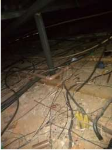
Fiação exposta sob laje, circuitos ao lado de tubulação hidráulica
