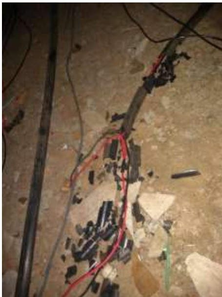
Fiação exposta sob laje, circuitos com emendas improvisadas, sobrecarregando disjuntores e passando ao lado de tubulação hidráulica
