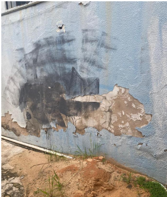
A PINTURA JÁ ESTÁ TOTALMENTE COMPROMETIDA
